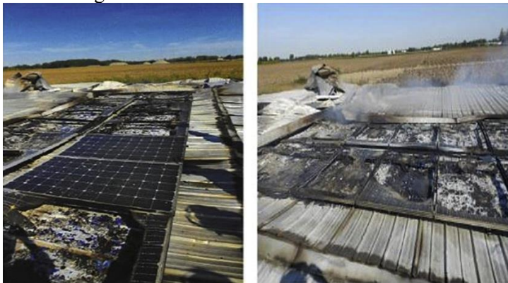
4. Ábra: Napelem panelek tűzkitörés utáni leégett állapotban [6].
